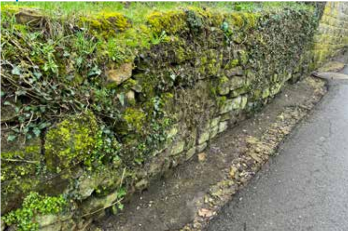
Zustand vor der Reinigung - Etat avant nettoyage
