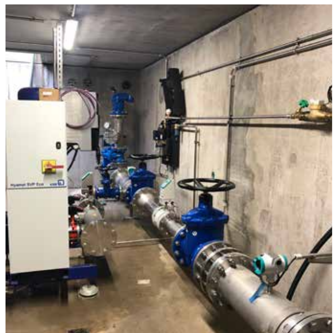
Rohrleitungen der Hauptleitung Tuyauterie de la conduite principale
