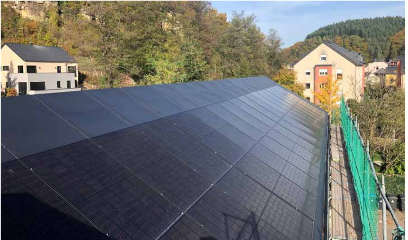
Von Verkleidungsblechen umgebene PV-Module Panneaux photovoltaïques entourés de tôles d'habillage
