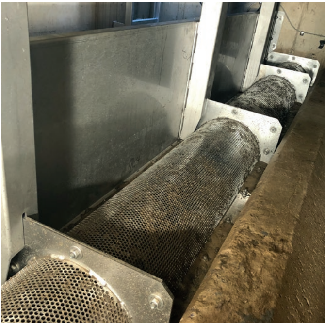
Bassin d'orage Place Bleech – Situation à l'intérieur – vue sur râteau
