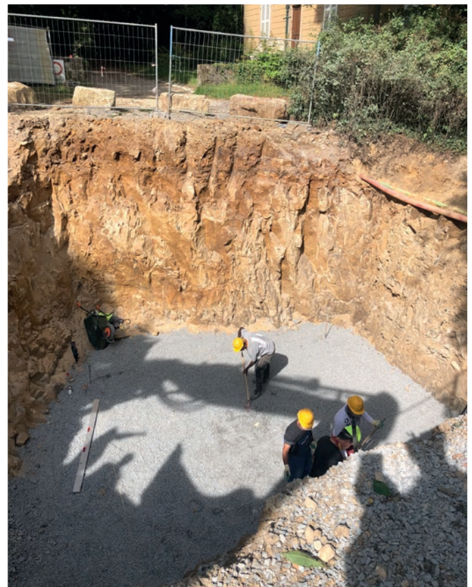
Terrassement pour le regard de raccordement d'eau potable et de la station de pompage pour le Château de Meysembourg
