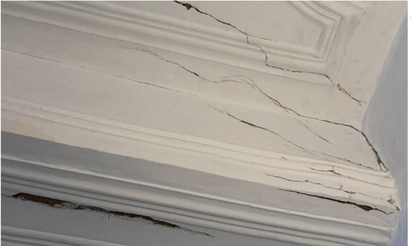
Deckenabschnitte während den Restaurierungsarbeiten Parties des plafonds pendant les travaux de restauration
