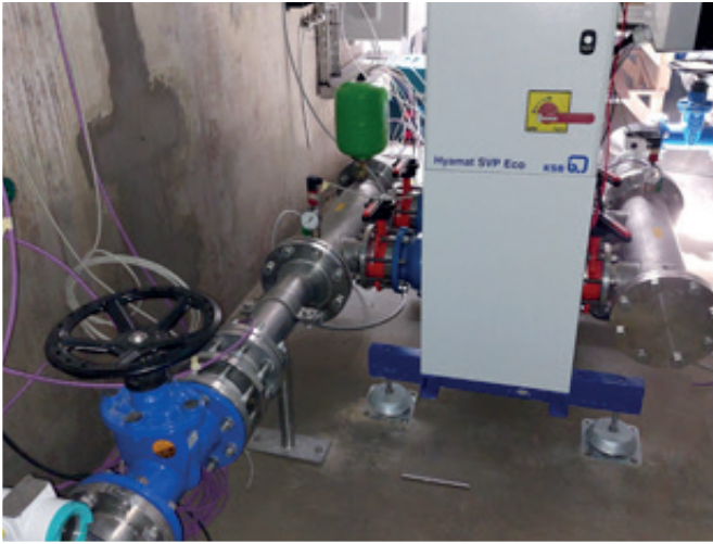
Tuyauterie dans la chambre à vanne au Guddelt Verrohrung im Schacht Guddelt
