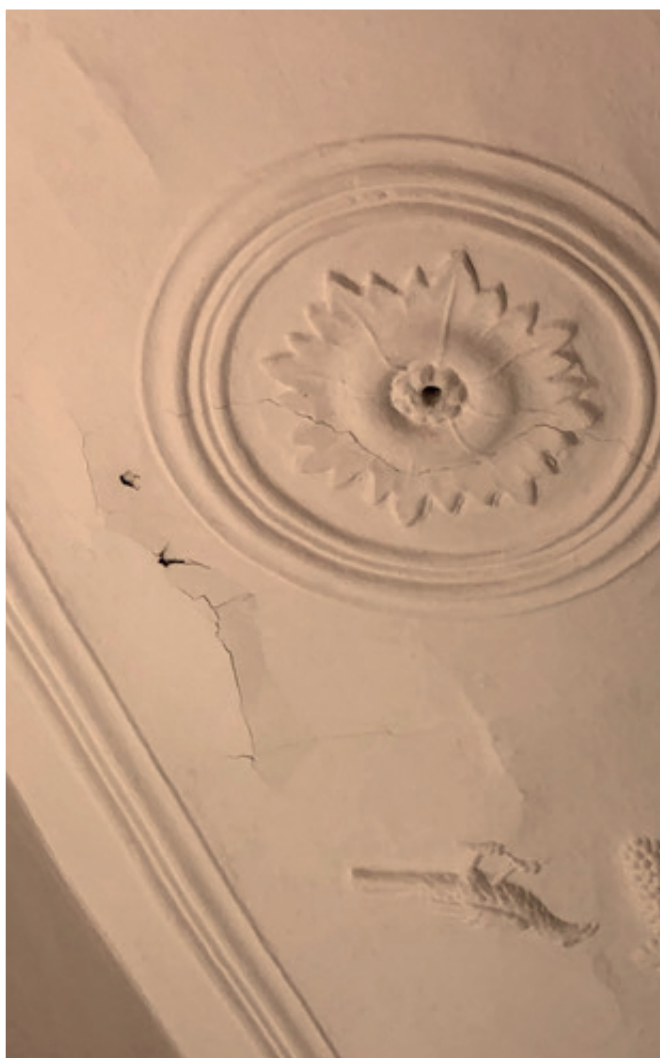
Gerissene und teils loselöste Decke
