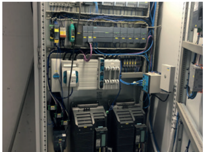
Schaltschrank mit Steuerungstechnik Armoire et installation technique de télétransmission
