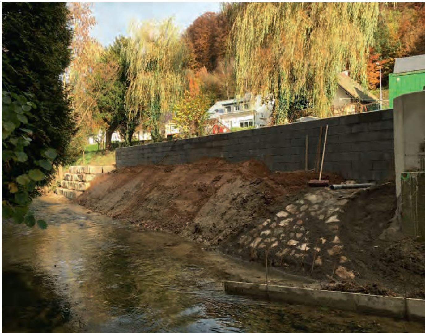
Mur de soutènement avec buse de sortie de la station de pompage d'eaux de ruissellement. Stützmauer mit Austrittsöffnung der Pumpstation des Regenwassers
