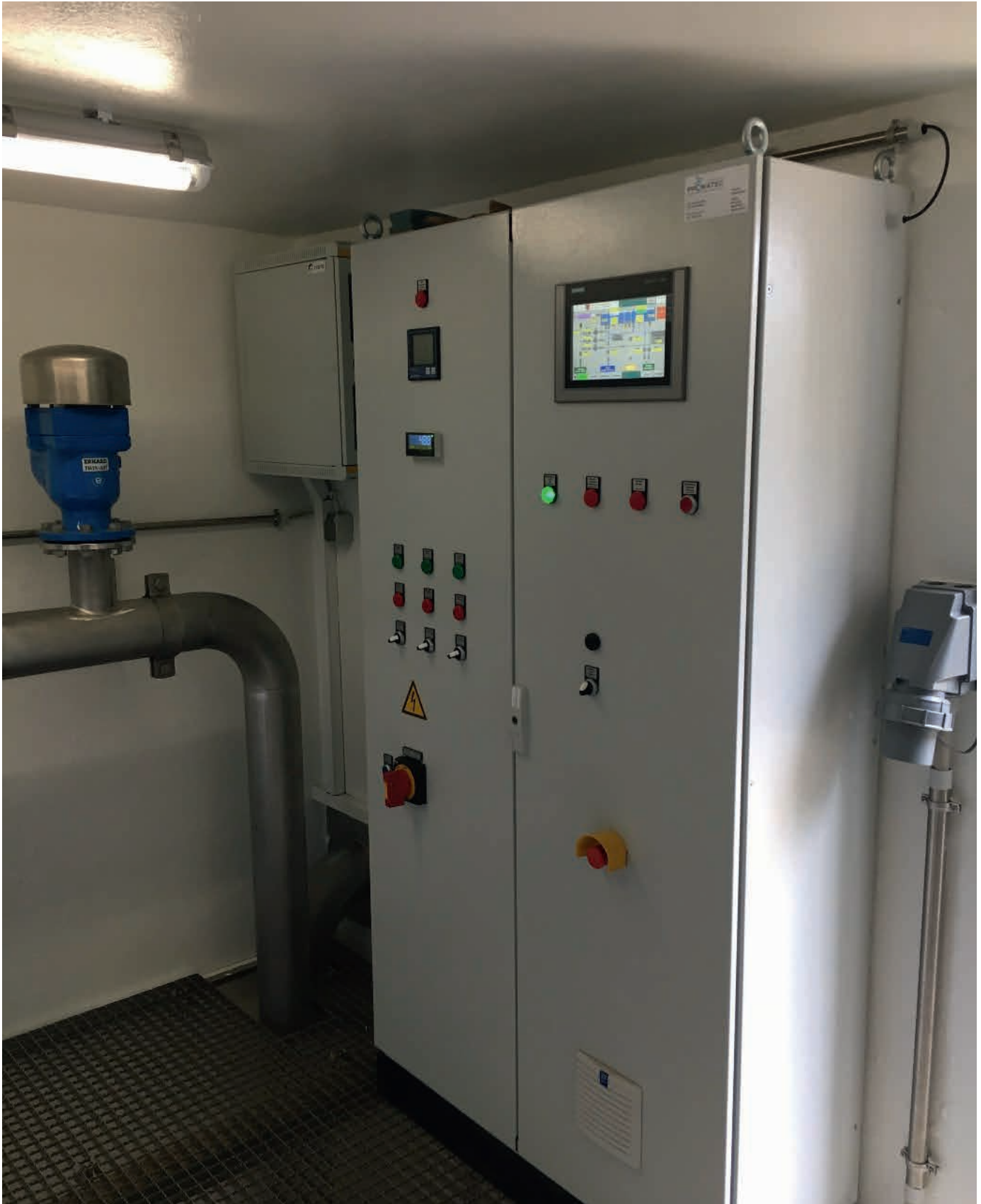
Système de surveillance et de réglage des installations de pompage - System zur Überwachung und Regelung des Pumpwerks
