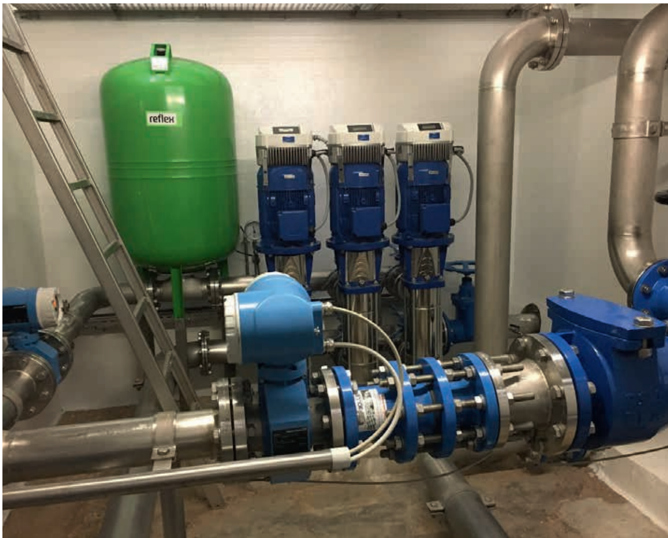
Nouvelles pompes installées au réservoir « Delsebett »-Neue
