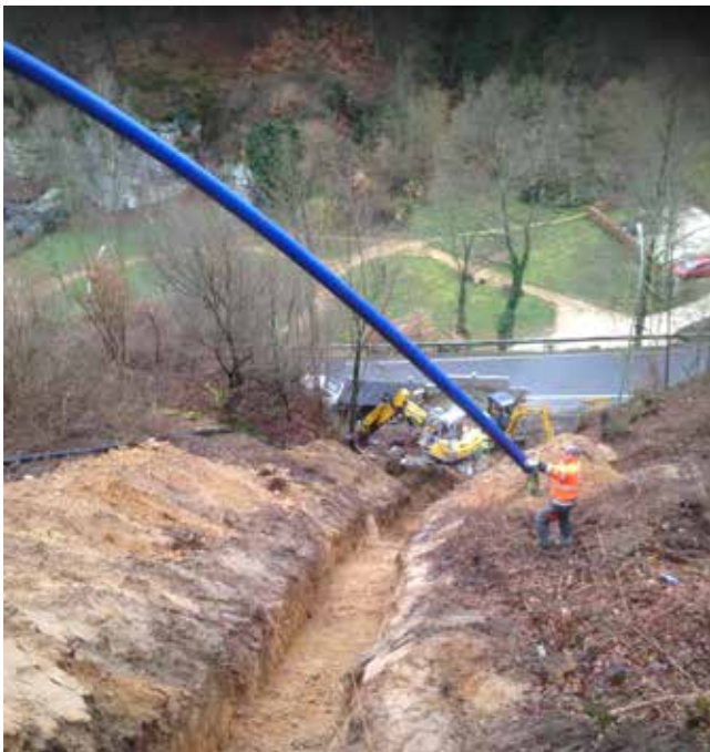
Graben zwischen dem Weg zur Burg und der Pumpstation „route de Mersch“
