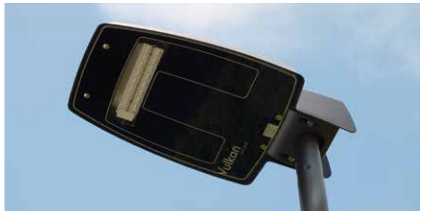
Neue Straßenbeleuchtung in der „Rue Leedebach“
