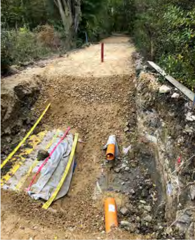
Tracé Ernzerberg – Schoos : en construction Die im Bau befindliche Strecke Ernzerberg – Schoos
