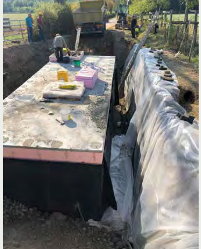
Chambre à vannes Guddelt - Ventilkammer Guddelt
