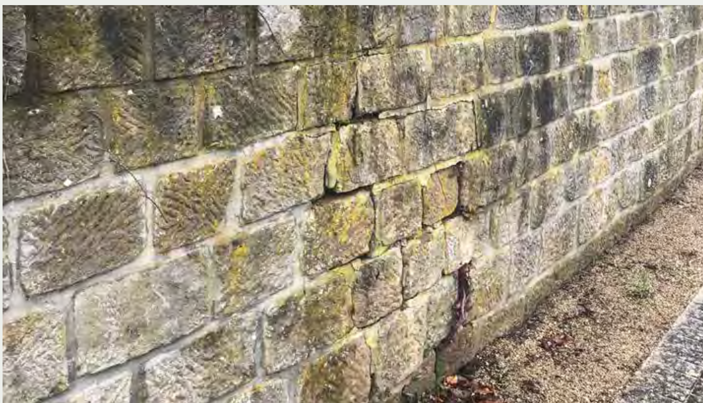
Mur déformé et nécessitant un assainissement. - Verformte und renovierungsbedürftige Wand
