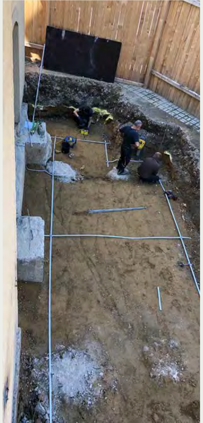
Préparation des fondations de la nouvelle cage d'escalier et d'ascenseur - Vorbereitung der Fundamente für das neue Treppenhaus und den Aufzugsschacht
