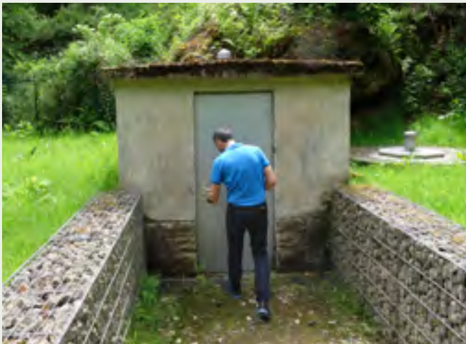
Trinkwasserfassung Ouschterbour (Schacht rechts) und Pumpstation (Häuschen links) Foto: Rachel Krier
