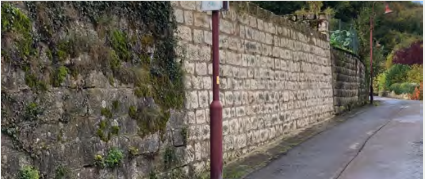
Première partie d'un mur de soutènement assaini dans la Rue Osterbour – Erster Teil einer sanierten Stützmauer in der Rue Osterbour
