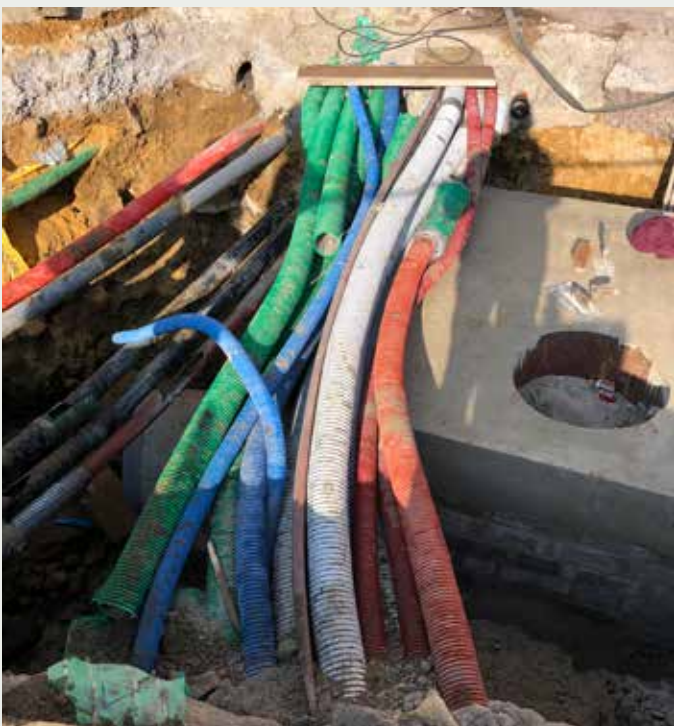
Regard de branchement au canal existant dans la route de Mersch avec des nombreuses gaines existantes - Schacht zum bestehenden Kanal in der Merscherstraße mit zahlreichen vorhandenen Leitungen
