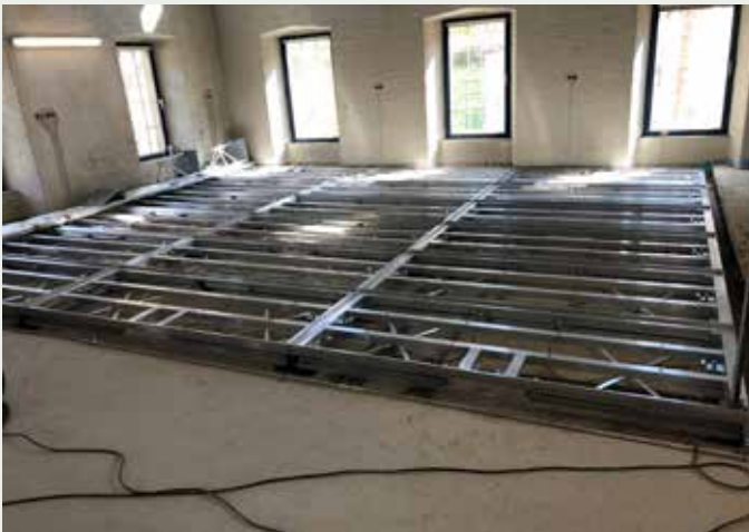
Installation de base des équipements scéniques – Grundlegende Installation der Bühnentechnik
