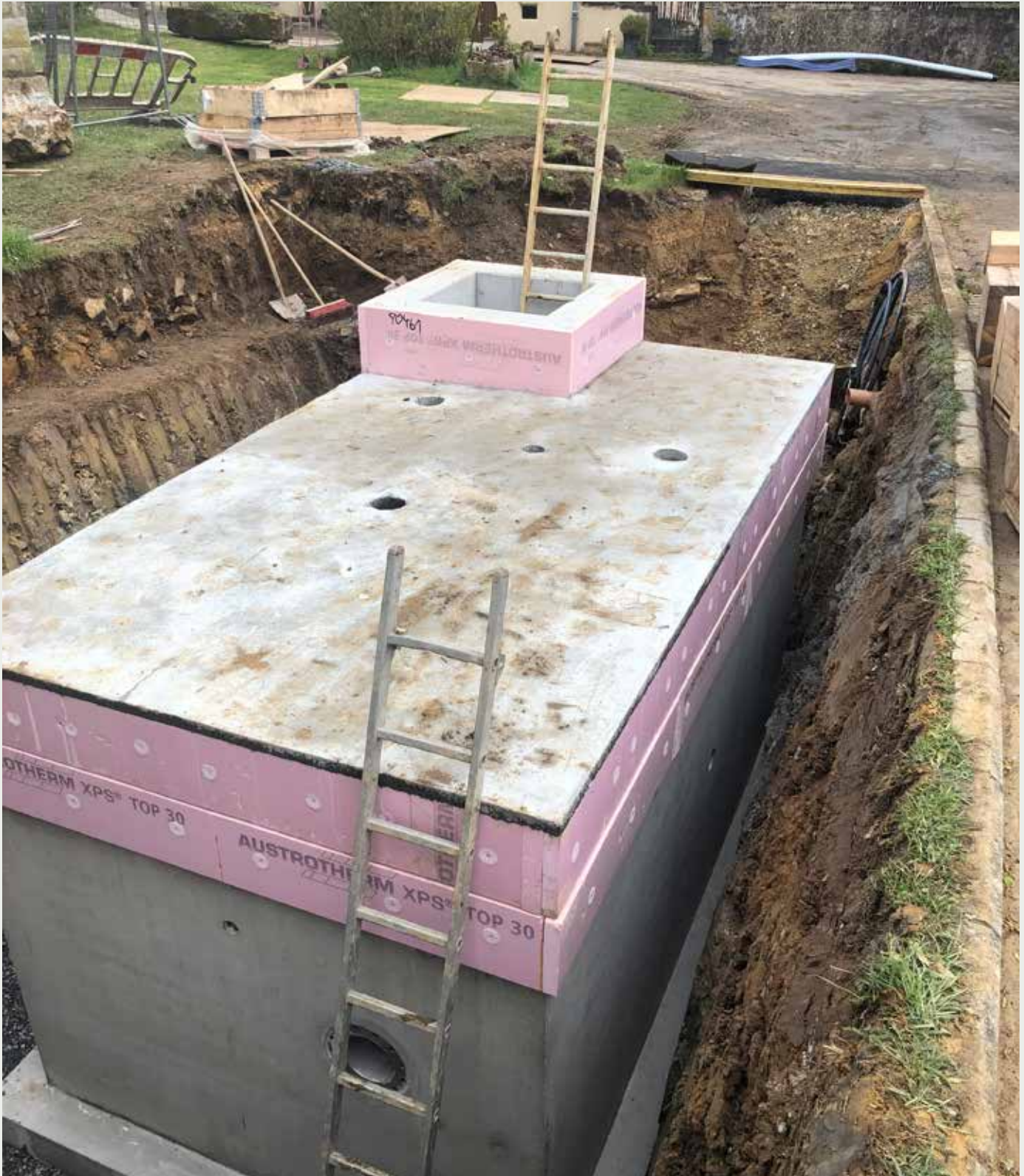
Regard de distribution « Ferme Weydert » - Schacht mit Abdeckung nahe des Weydter Hofes
