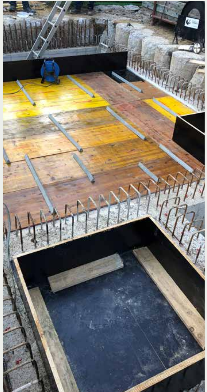
Bassin d'orage place Bleech – Dalle coffrée avant bétonnage - Regenrückhaltebecken auf der Place Bleech - Schalungsplatte vor dem Betonieren
