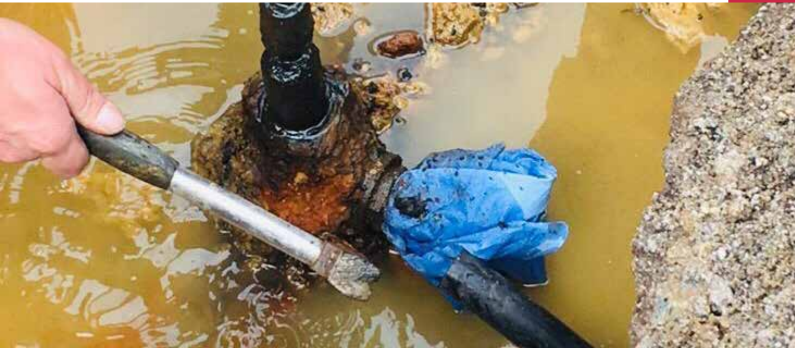
Leck Rue de Medernach – Fuite d'eau dans la Rue Medernach
