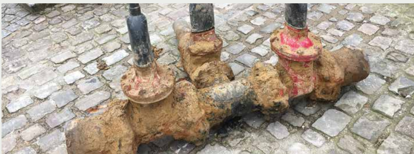
Altes Schieberkreuz (defekt)- ancienne croix de vanne défectueuse
